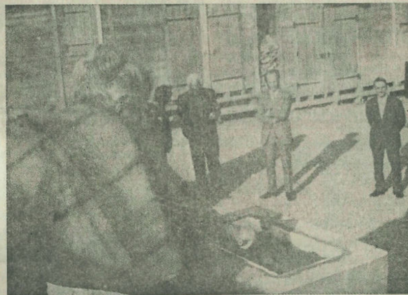
Auch zarte Hände helfen beim Zumauern des Grundsteins mit. Im Bild Frl. Ursprung vom Schweizer Verband Volksdienst.
