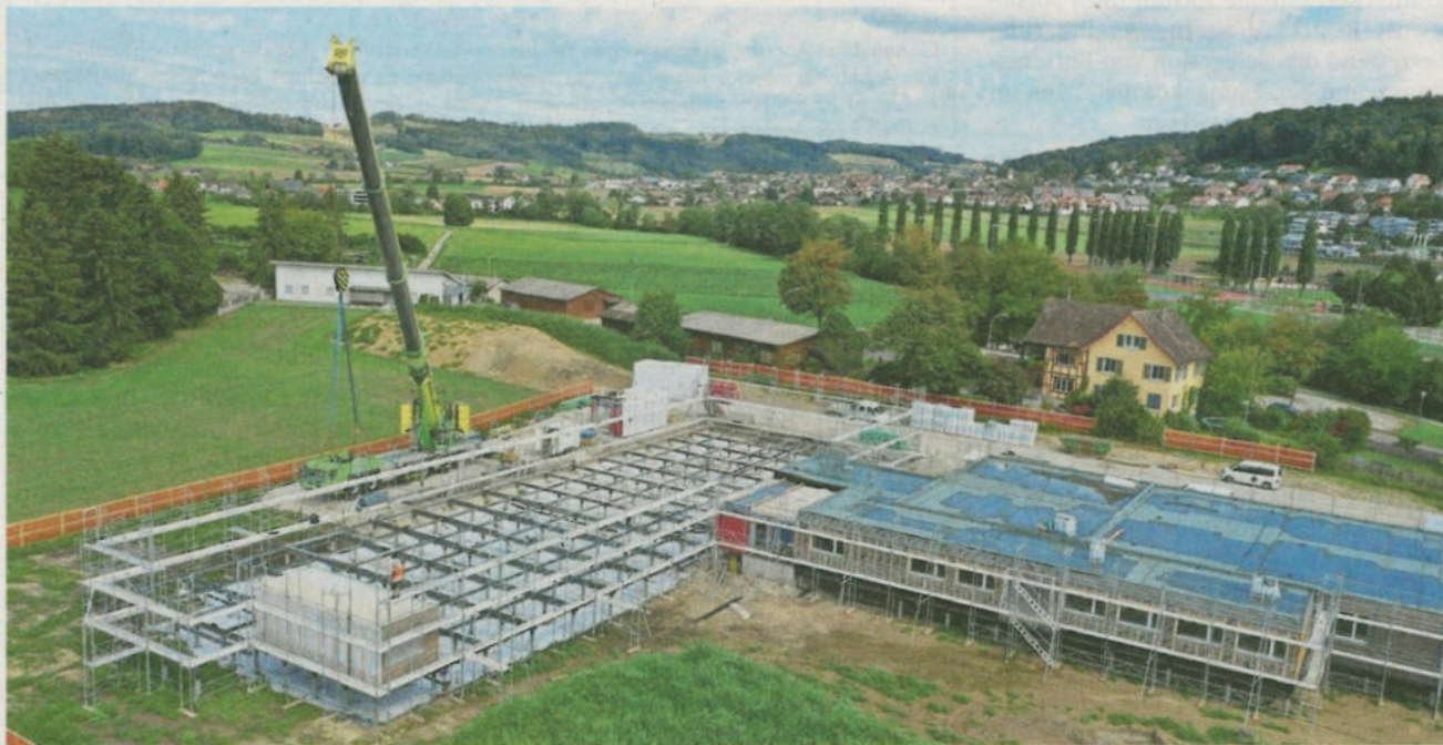
Auf dem Giessen-Areal in Affoltern entsteht derzeit das Provisorium für das Pflegeheim Seewadel. (Bilder zvz.)
